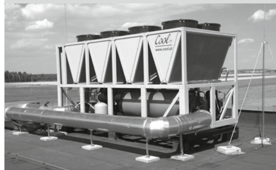
Przykład typowej lokalizacji na zewnątrz budynku preferowanej dla chillerów z R290.
